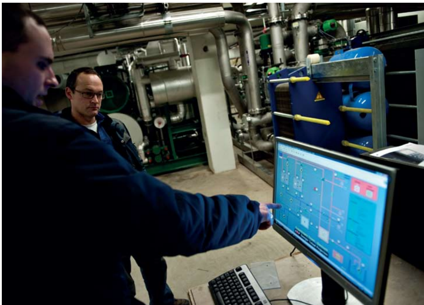
Maskinmester Torben Meltofte, tv., og køletekniker Jens Junggren overvåger det nye anlæg i Copenhagen Towers.
