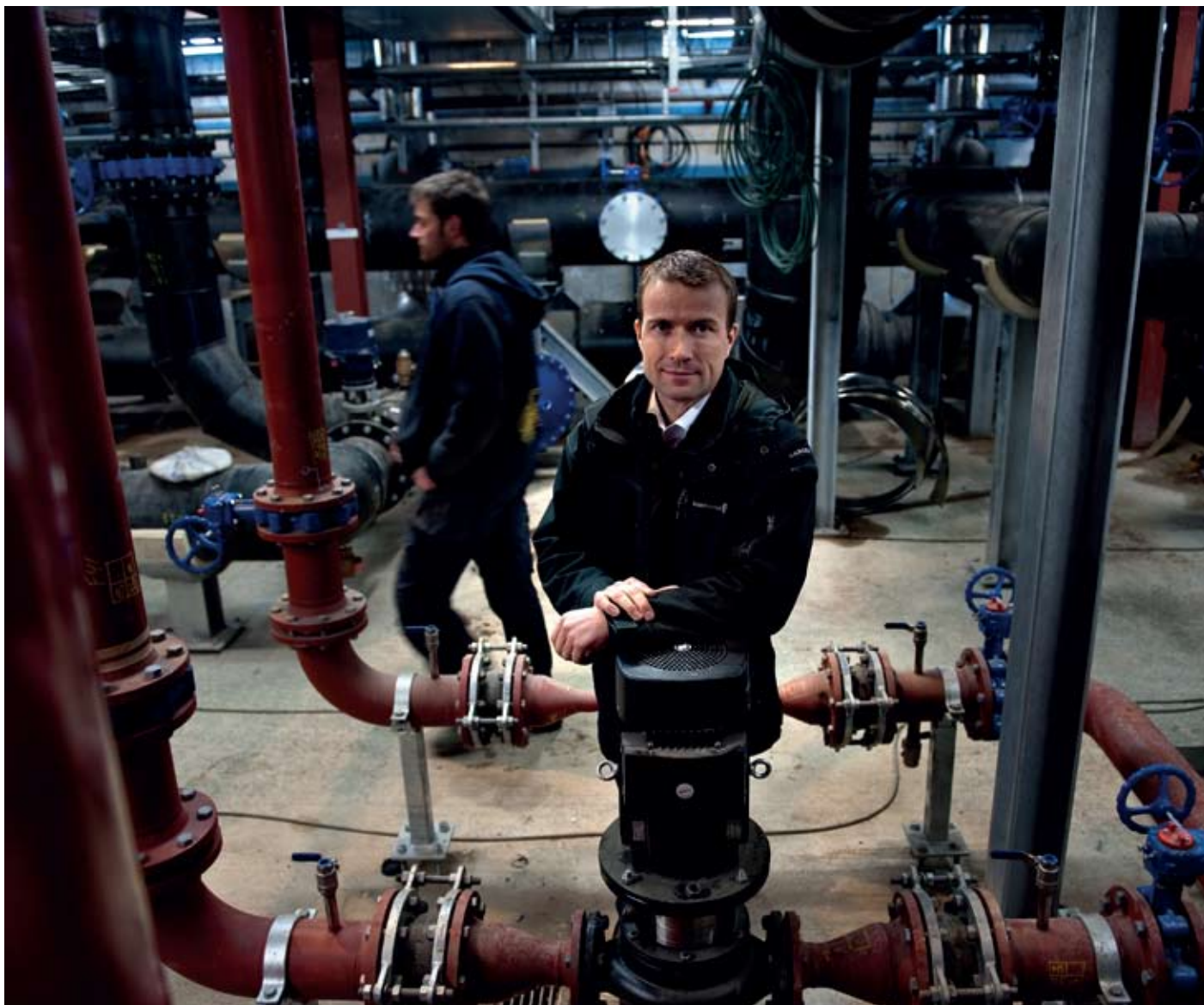
Jan Don Høgh i kælderen med kølecentralen, hvor pumper, filtre og det meste af rørføringen er placeret.
