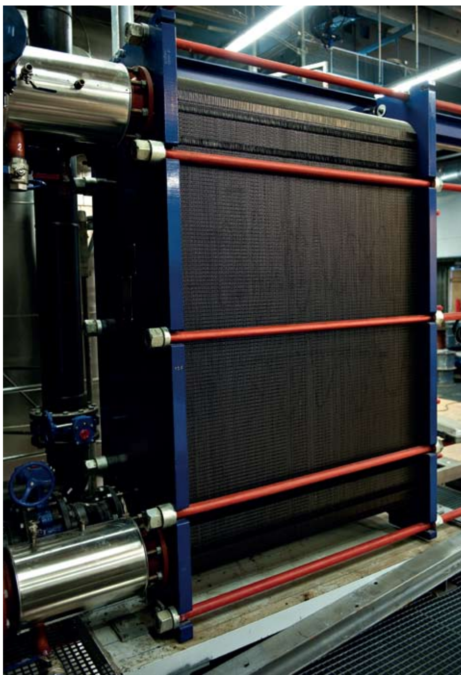
Titaniumshavvandsveksler som bruges til frikøling.
