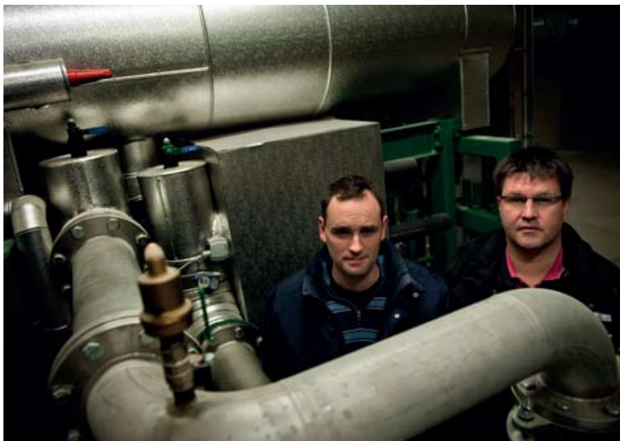
Teknisk chef Henrik Winther, th., og maskinmester Torben Meltofte fra GEA Grenco Køleteknik, der har leveret af anlægget til Københavns nye vartegn.
