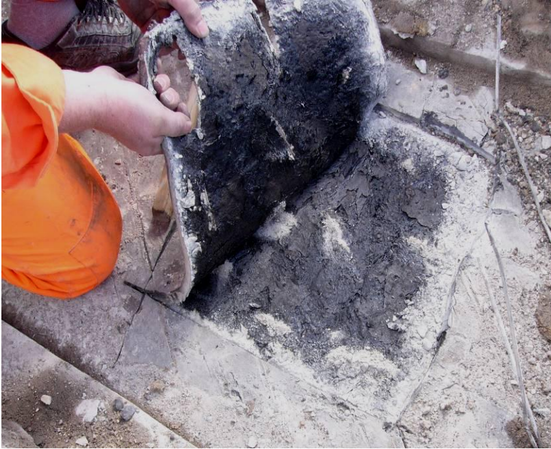
Tilstandsvurdering: membran ældet men næppe utæt
