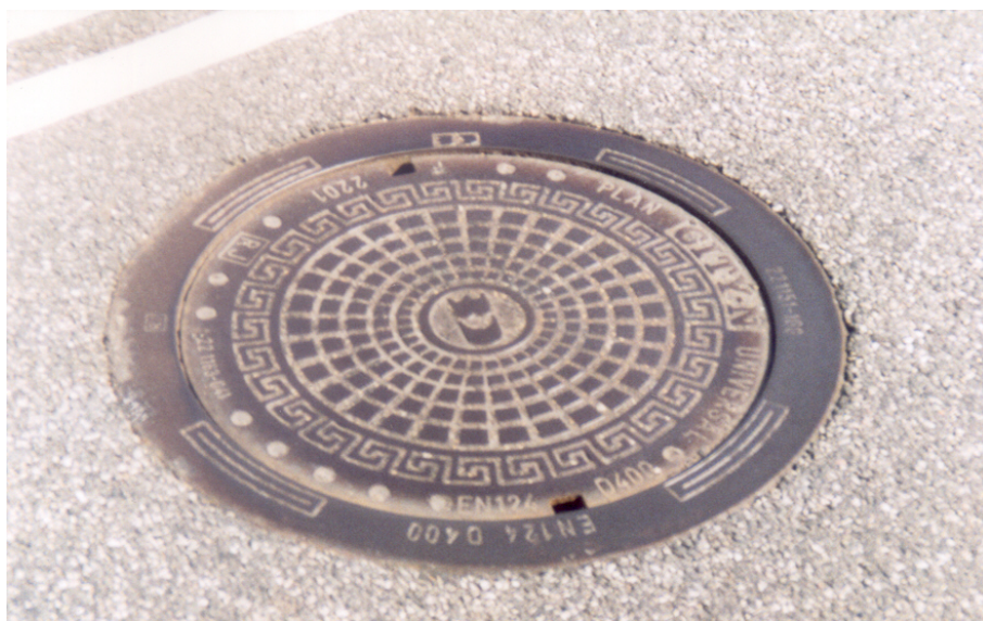
Figur 10.5 Dækslet er sunket i forhold til karmen
