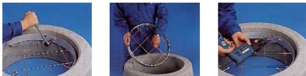
Figur 5.1 Sikkerhedsindsats i betonkegle
