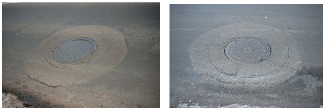
Figur 10.8 Dårligt udførte reparationer
