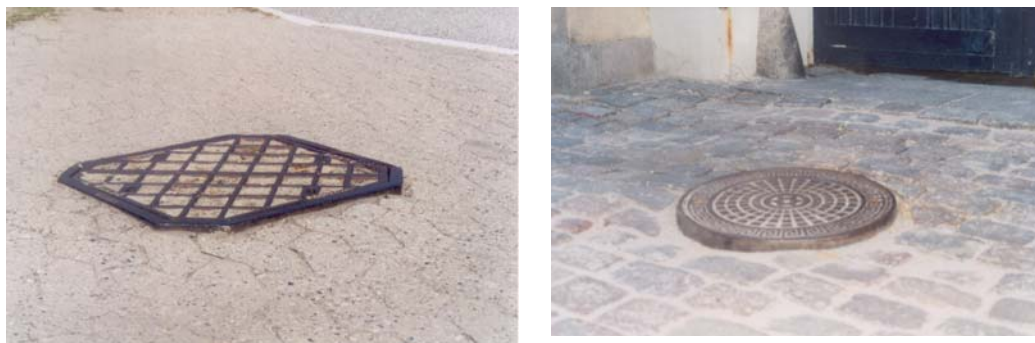
Figur 10.7 Dæksel, der ligger over belægningens overflade
