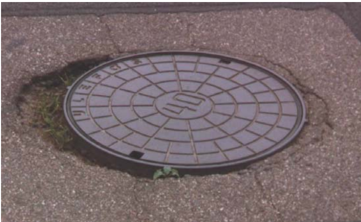
Figur 9.2 Dæksel, der er så dårligt monteret, at det udgør en sikkerhedsrisiko
