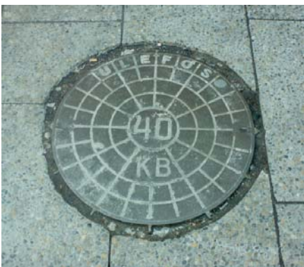
Figur 4.15 Dårlig afslutning med belægningssten mod en rund karm
