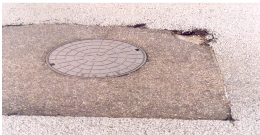
Figur 10.3 Afskalning i hjørnet af en udført reparation
