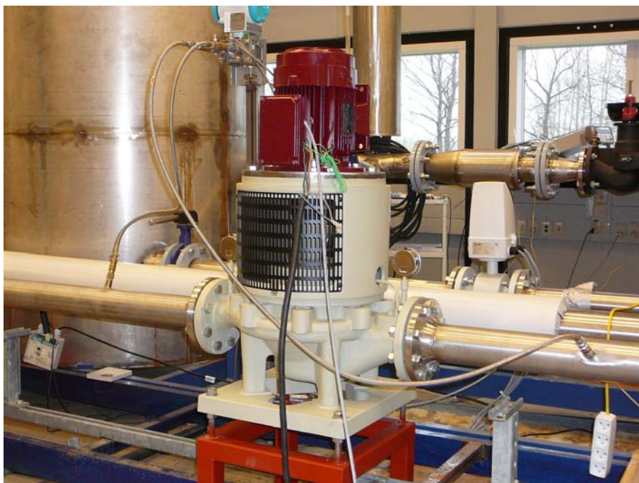
Figur 5.4. Test af NSL 80-265 med PM motor
