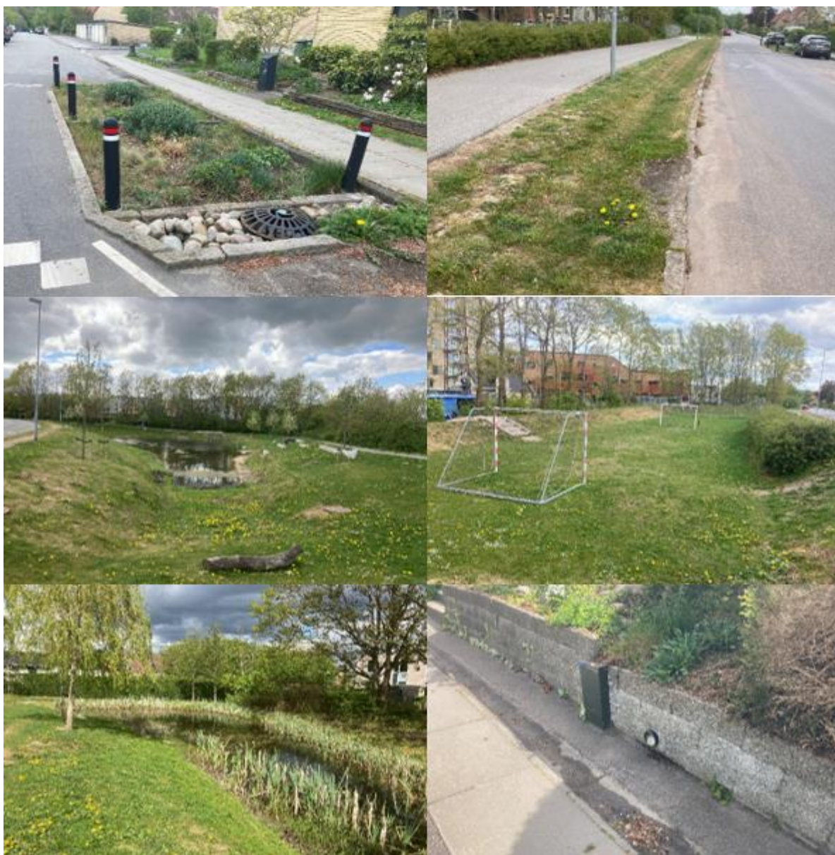
Figur 4: Anlæg ved Gustav Holms Vej. Øverst tv. vejbed, øverst th. wadi; midt tv. regnvandsbassin top, midt th. skybruds-bassin/boldbane; nederst tv. regnvandsbassin bund, nederst th. kantstensafledning. Foto: Teknologisk Institut
