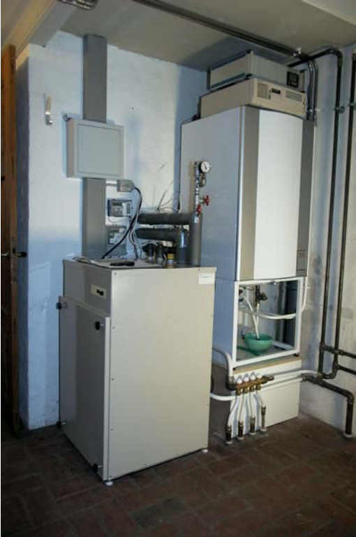
Figur 1: Behovsstyret varmepumpe (Salling Vaske- og Køleservice) udstyret med målegrej.
