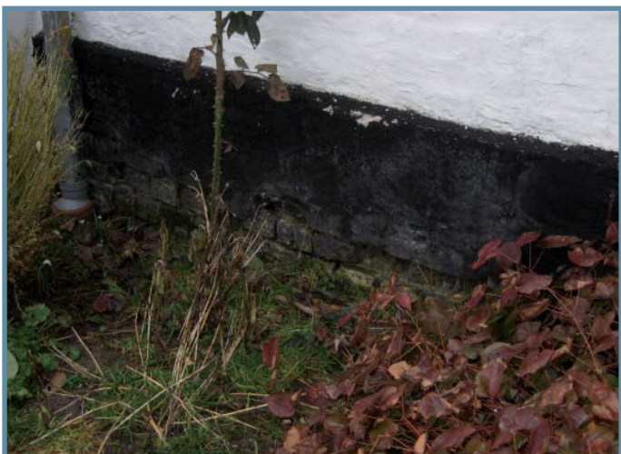
Fugtopstigning i ydervægge
