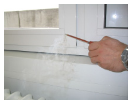
Synlige utætheder vha røgen
