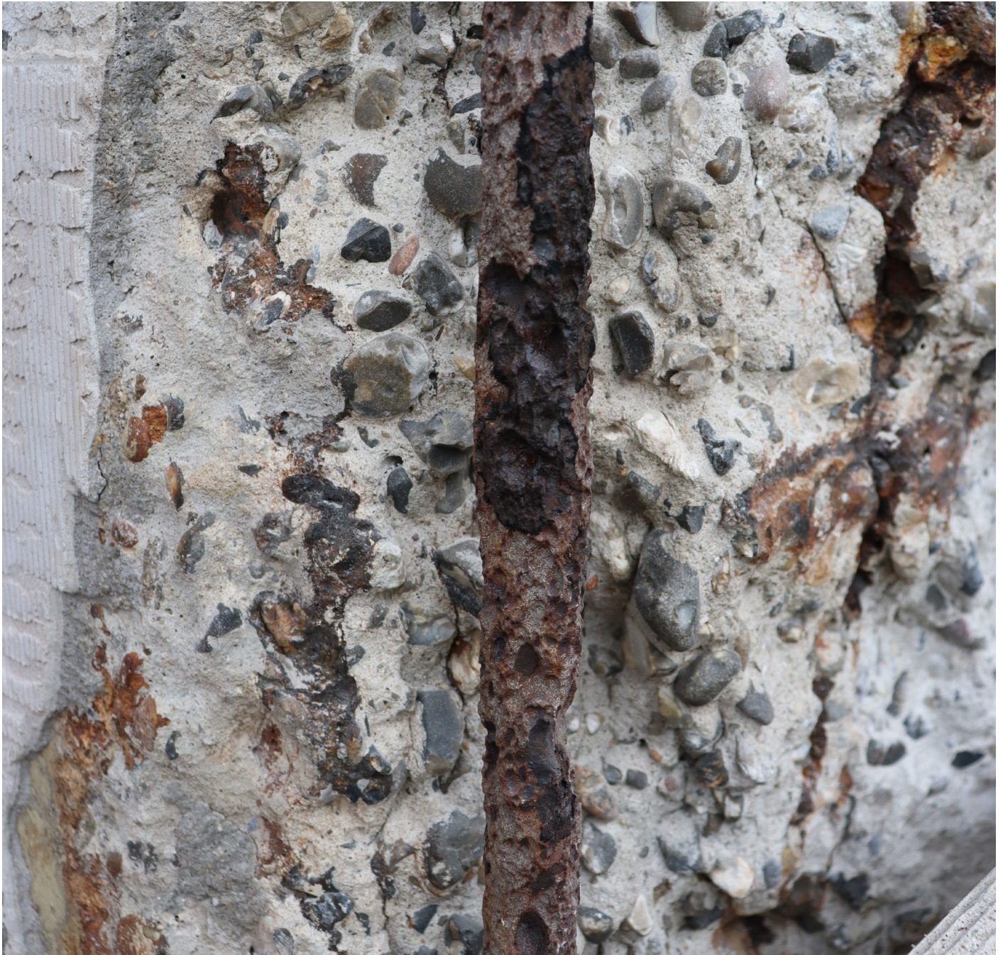
Fig. 16 Højt kloridindhold i betonen kan resultere i korrosion af armeringen. Når armeringen korroderer, reduceres konstruktionens bæreevne. Foto: Teknologisk Institut
