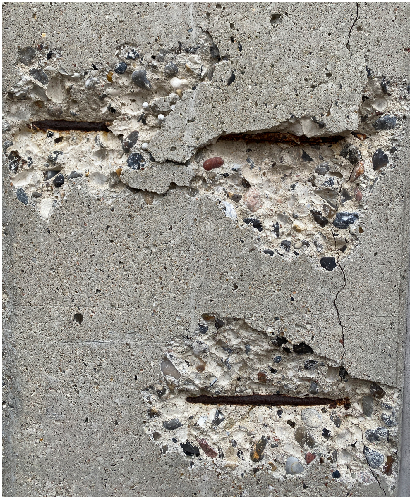
Fig. 14 Afskalning af dæklag som følge af armeringskorrosion. Foto: Teknologisk Institut
