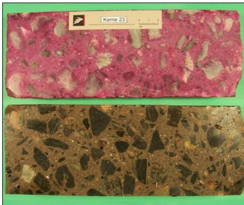
Strukturanalyse. Betonens overflade er mod venstre. Øverste kernehelvdel er sprøjtet med pH-indikator (phenolphthalein).
