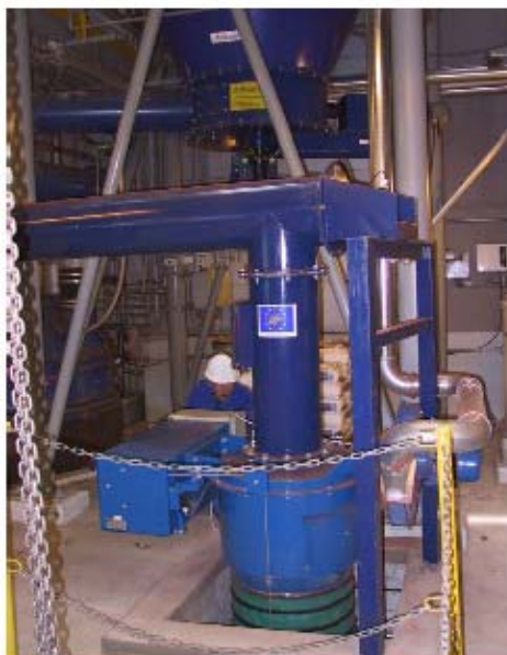
Askesiloens bund, den nye snegletransportør og bælggen på Spildevandscenter Avedøre.
