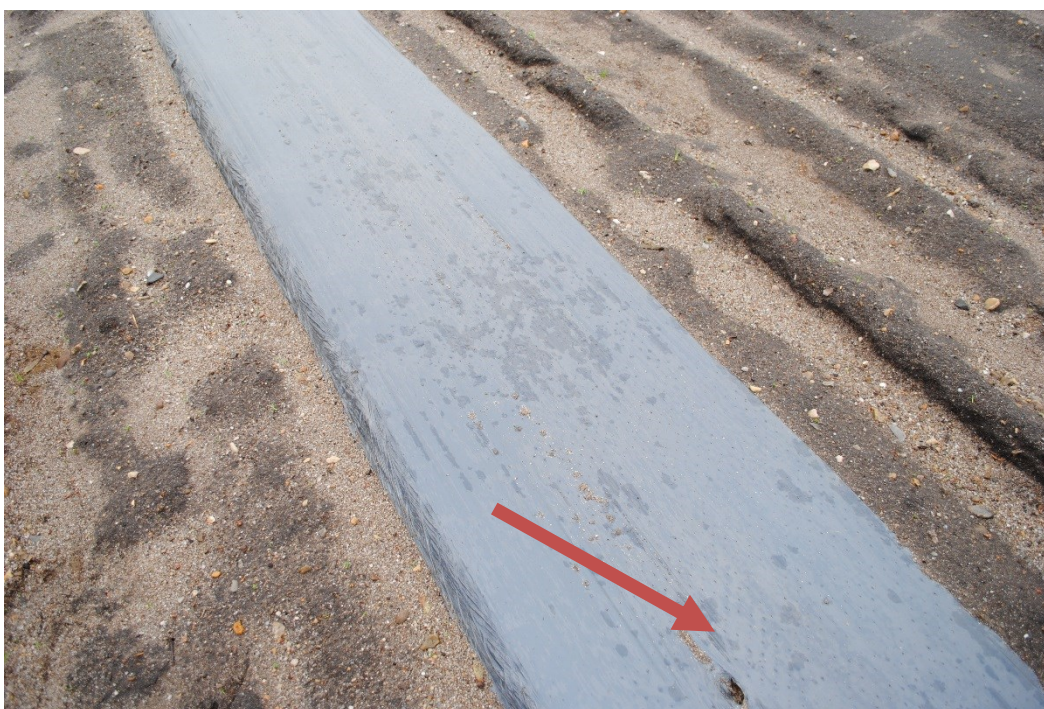
FIGUR 5.33: RÆKKE MED ENKELTLAGSFOLIE B TYKKELSE =20 MICRON. INTAKT, - DOG MED SKADER FRA DYR.
