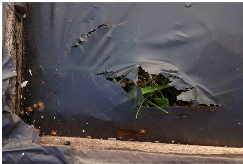
FIGUR 5.10 FOLIER PÅ GRÆS DEN 14. AUGUST – HUL I SORT A SAMT REVNE.
