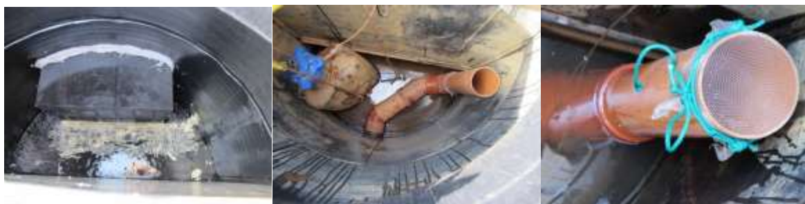
Figur 38. Fotos af udløbsbrønd. Venstre: Kig ned i hjørne af brønd afskåret fra resten af brønden med 'vende-L' i form af to tilpassede plader, tætnet med silikone mod brøndvæggen. Øverst ses udløbskassetten fra forfilteret, der ligger over indløbskassetten til hovedfilteret. Midt: Kig ned i resten af udløbsbrønden, bagved "vende-L". Udløb fra hovedfilter sker under bunden. Til venstre ses passivprøvetageren (dunk med blå låg) og til højre ses det forhøjede udløb. Højre: Net monteret på forhøjet udløb for at undgå tilstopning af flowmåler med flis fra gangstier omkring anlægget.
