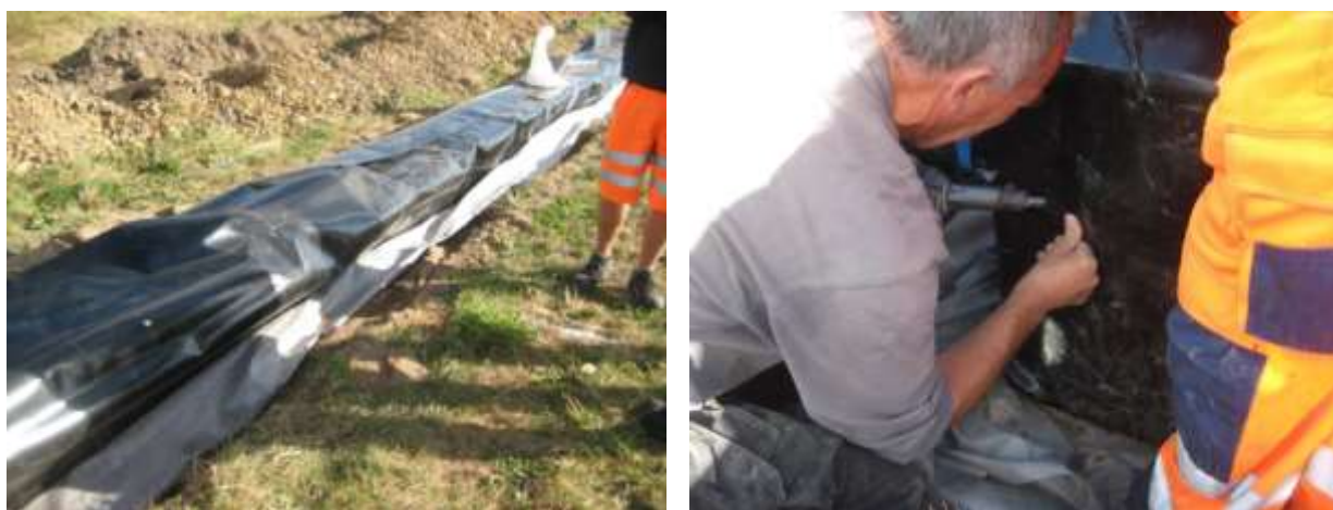
Figur 32: Omsluttende PE-membran tættes ved svejsning omkring manchetterne og i samlingen på oversiden af filteret. Det var ikke muligt at svejse PE-membranen ordentligt fast omkring manchetterne på brødene pga. tykke kanter på manchetterne. Trods flere forsøg lykkedes det ikke at gøre filteret 100 % tæt. For at sikre at vandet strømmer korrekt gennem filteret blev der lagt en ekstra membran mellem forfilter og øverste sektion af hovedfilteret. Der blev også svejset ekstra PE-membran på siden af DPF-kassetterne i hovedfilteret. Efter bygning blev anlægget dækket med jord, og der blev lagt flis på gangstier til brøndene (Figur 33).
