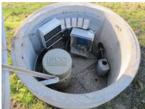
Figur 24: Prøvetager (1) ses til venstre, og til højre flowproportional bulk prøvetager (2) med magnetventil og 9 L dunk.
