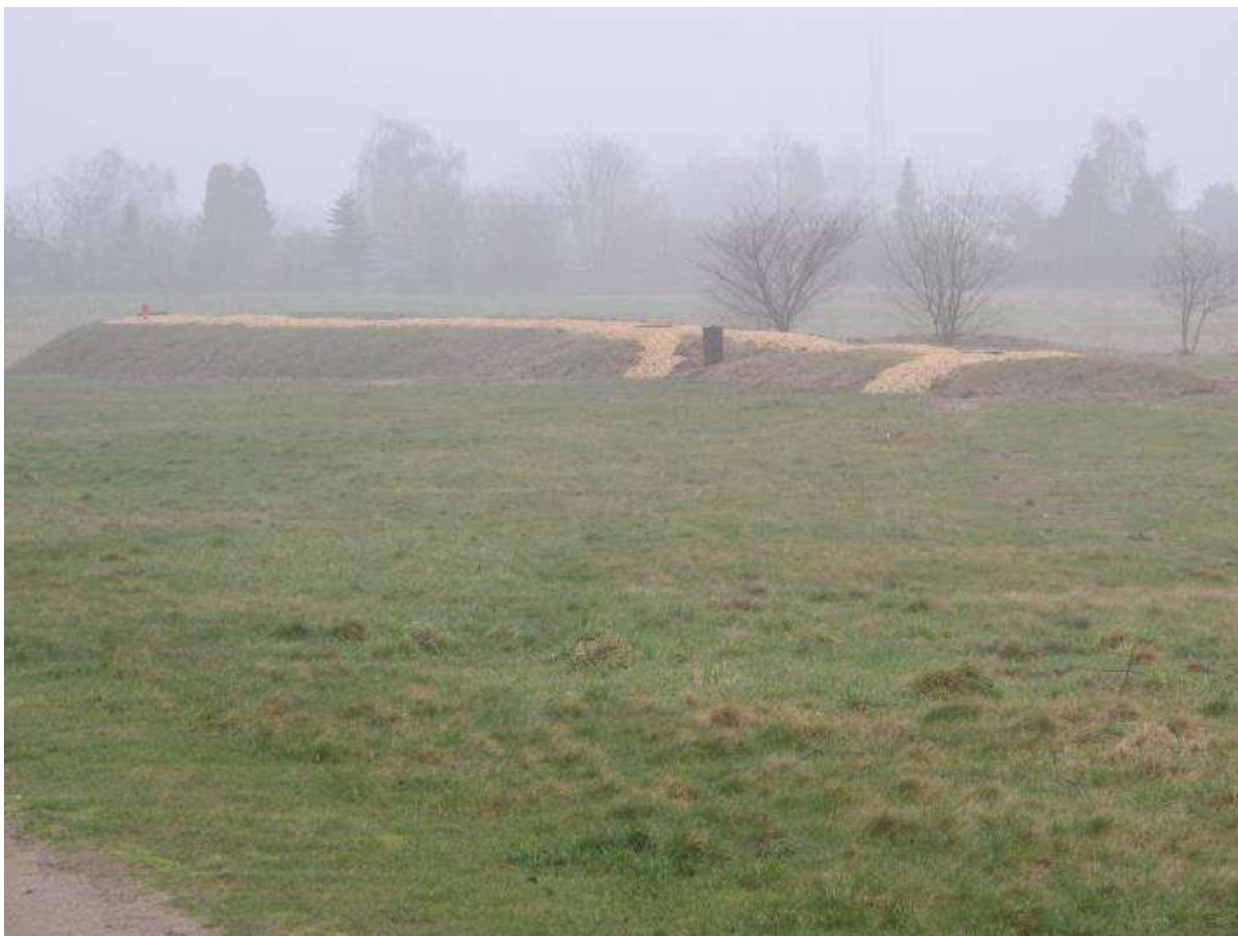
Figur 33: DPF-Mårslet, nogle gange kaldet "hvalen", dukker op i tågen ved ankomst en morgen. Oppumpningsbrønd er i venstre side, udløbsbrønd i midten og fordelerbrønd i højre side. Det mørkegrønne skab indeholder flowmålerens display, konverter og telemetri. Der er lagt flis på gangstier til brøndene.
