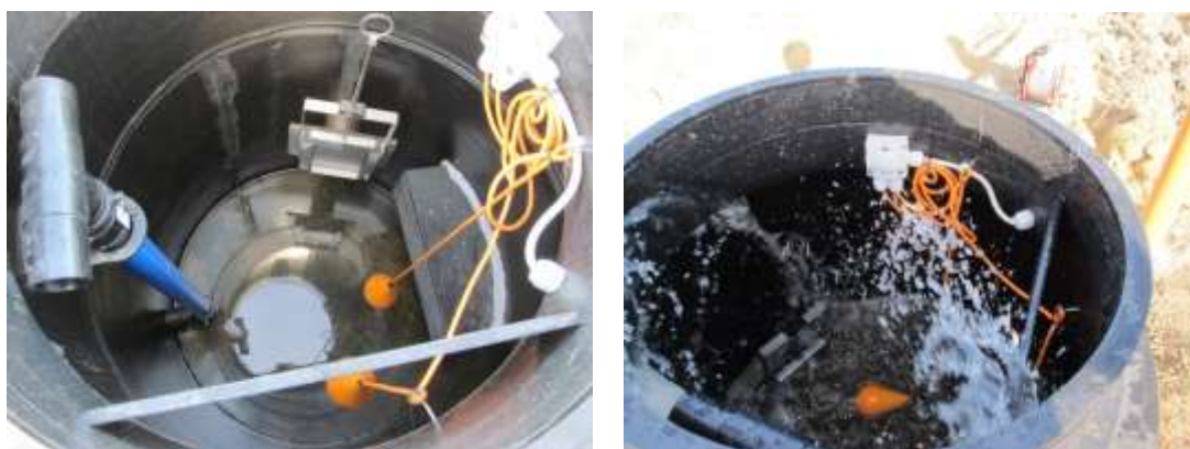
Figur 36. Fotos af Indløbsbrønd. Venstre: Trykledning fra pumpe, der ender i T-stykke, skydespjæld til bypass af filteret (øverst), indløb til forfilter i form af første DPF-Kassette i forfilteret, der er skudt ind i brønden (nederst til højre). De orange kugler er de to niveaupper til styring af pumpen. Højre: Vand strømmer ind i brønden.
