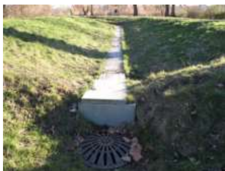
Figur 16: Forfilter med synligt låg lavet af brune plyfaplader (=støbekrydsfiner). I forgrunden ses oppumpningsbrønd BR02 og overløbsbygværk foran forfilter. Bag bygværket ses hængsler på låg til indløbskammer. I baggrunden anes jordvold efter forfilteret.
