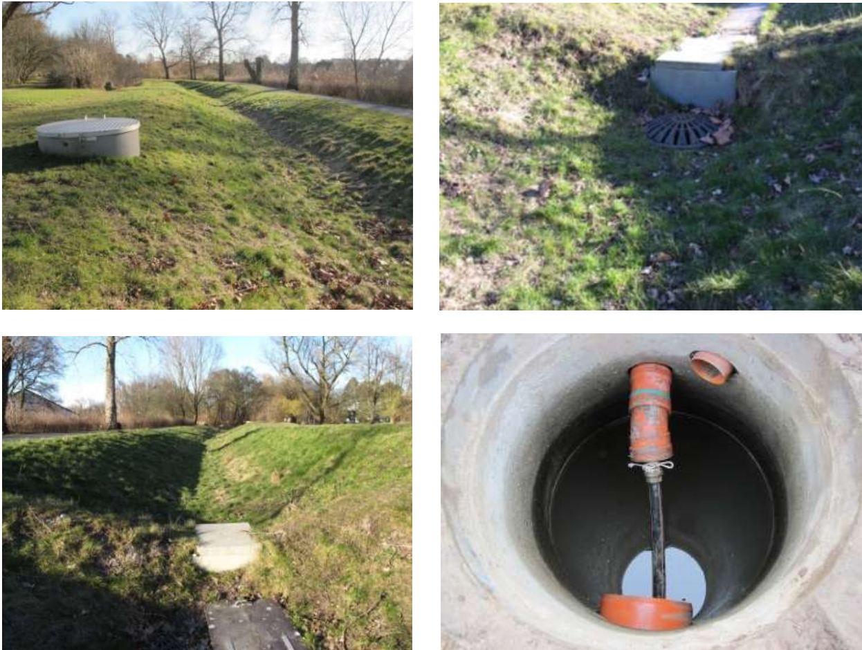
Figur 14. Øverst t.v.: 50 m langt tørt bassin til forsinkelse af afstrømning for rensning og udledning. Benævnes "Græsbassin". I forgrunden ses indløbsbrønd BR03. Øverst t.h.: Vandet ankommer til græsbassinet via BR03 der er forbundet til opstuvningsbrønd BR02, som har en kuppelrist. Når der er plads i BR03 løber vandet tilbage til BR03 igen via kuppelristen. Nederst t.v.: Kig fra forfilter mod græsbassin. Nederst t.h.: Kig ned i brønden under kuppelrist. I bunden ses Ø300 rørledning, der forbinder indløbsbrønd og græsbassin. Gennem samme rør er trukket pumpeslangen, der pumper vejvand fra BR03 ind i forfilteret. Røret kl. 11 afdræner evt. forsinkelsesvolumen over forfilter.
