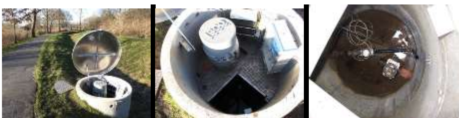
Figur 22: Udløbsbrønd. På mellemdæk står ISCO fraktionsopsamler og på væg hænger strømforsyning og kasse med telemetrimodul og flowmålerens konverter. I bunden ses flow sensor (lys prik), forhøjet afløb (sort rør) og afløb til Harrestrup å gennem drejeventil.
