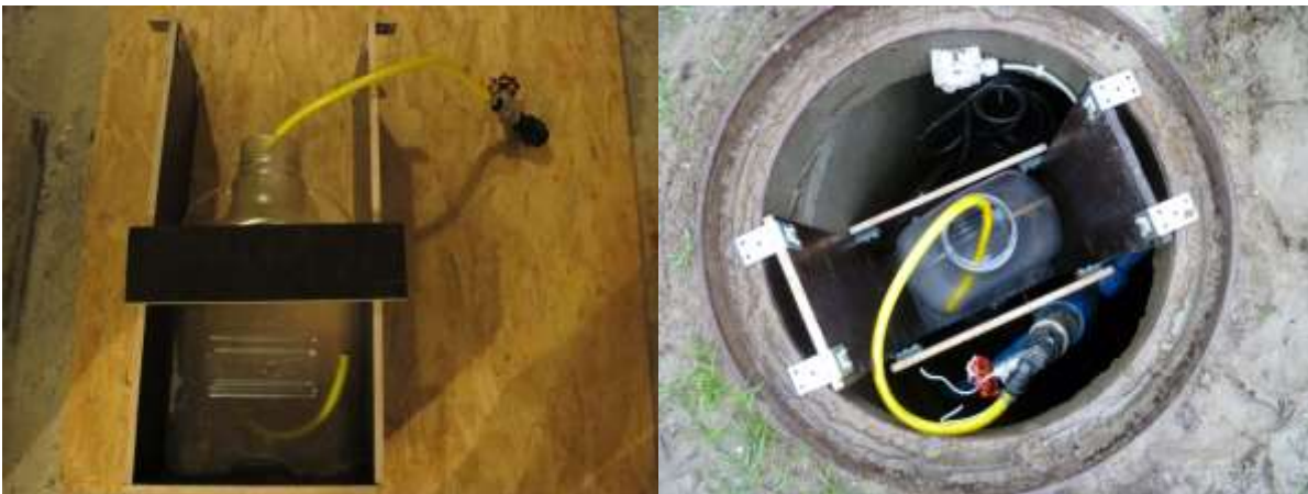
Figur 40. I brønden med pumpen kan der udtages flowproportional bulkprøve af indløbsvand til DPF-Mårslet. Der udtages en delstrøm fra tryksiden af pumpen gennem en præcisionsventil (rødt rundt håndtag) til en 25 L dunk i HDPE, der er placeret i en holder af vandfast krydsfiner.
