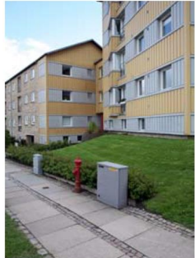
Ny gavle med profilerede metalplader og lignende skæmmer facadeudtrykket totalt.
