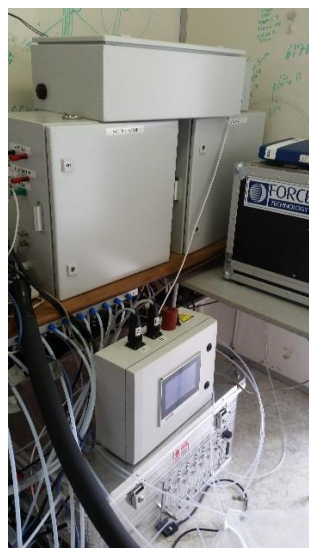
Figur 21. Foto fra målestationen i Skanderborg: FORCE's multiplexer inkl. PLC styreenhed (nederst, på gulv), prototype A og B (grå kabinetter på bord midt i billedet). Øverst dataloggeren og bagest (mod væg) skimtes pumpe modulet til prototyperne.
