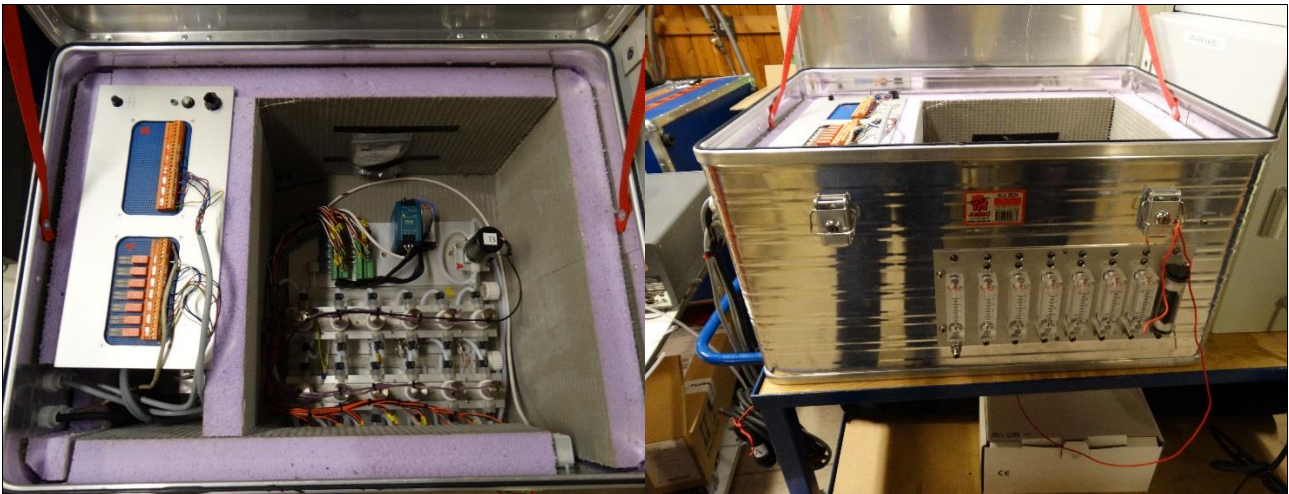
Figur 30: Indvendig husning af multiplekser enheden uden nogen tegn på påvirkning fra atmosfæriske korrosion.
