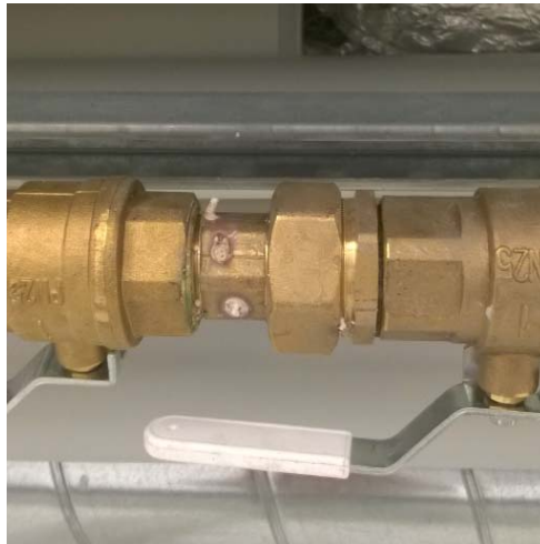
Men efter 3 års användningen var där tecknen på avzinkning
