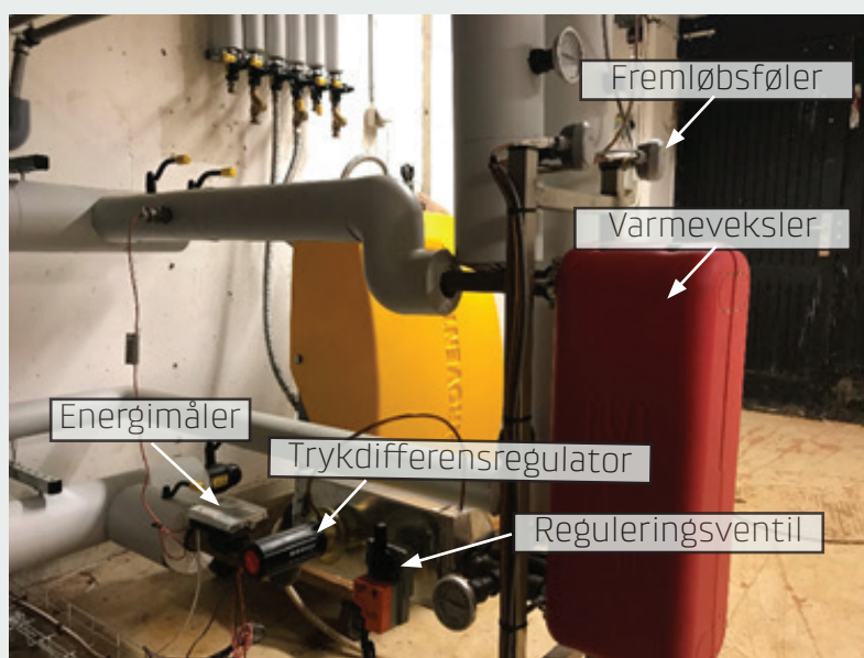
Figur 3 – Indirekte anlæg (med varmeveksler). Regulatoren er ikke vist på billedet. I dette tilfælde kan varmekurven indstilles fra CTS anlægget.
