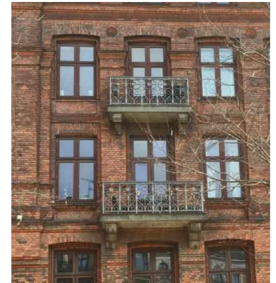
Figur 7 Ofte ses ved betonplader, at der er udført dekorationer af puds af cementmørtel på undersiden af altanen – en slags pyntekonsol. NB : Cementpudsen må ikke forveksles med beton. Pudsen har dekorative formål, betonen er bærende.
