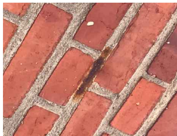
Figur 41 Korrosion af indmuret murbinder på underside af muret loft.
