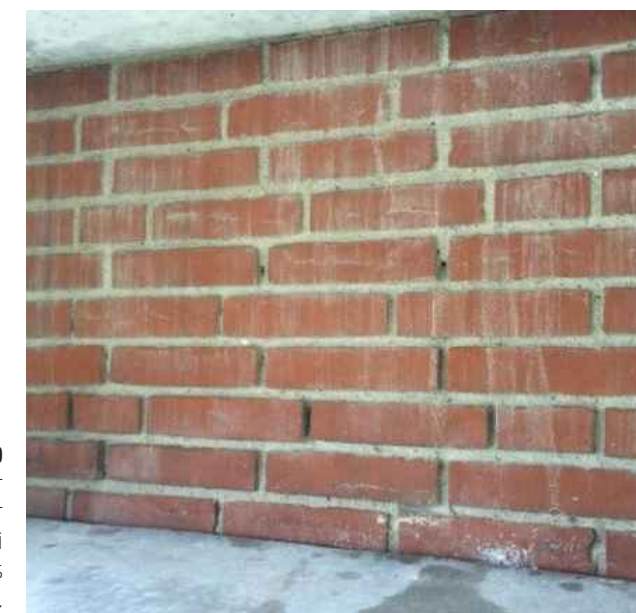
Figur 40 Underside af altangang i beton, hvor overfladevand og salte er ledt til murværket. Den visuelle tilstand af murværket giver her en indikation af, at betonen kan være saltbelastet, og det vil i dette tilfælde være en god ide at få udført en analyse af betonens chloridindhold samt at få vurderet armeringens tilstand nærmere.
