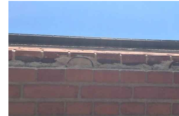
Figur 43 Hjørne ved underkant af brystningsmur og loft kan være kritisk. Her ses rust i armering, som forbinder betonplade til mursten i hjørne.
