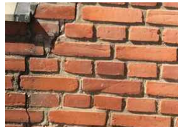
Figur 44 Subparallel revnedannelse i facademurværket undersøges ved bankning/prøveudtagning. Evt. murbinderes tilstand bør undersøges.
