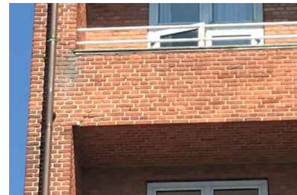
Figur 42 Særligt hjørne ved underkant af brystningsmur og loft over underliggende altan kan være kritisk.
