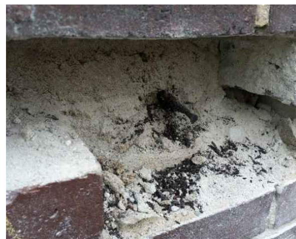
Figur 48 Korrosionsprodukter viser sig som rustflager.
