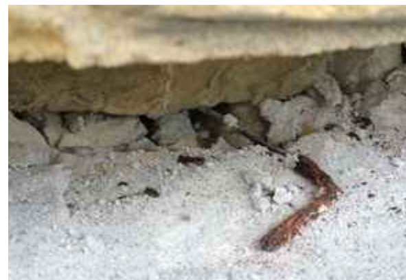
Figur 47 Korrosion af murbinder i hulmur.
