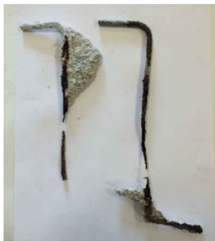
Figur 46 Korroderet murbinder udtaget fra hulmur med stærkt reduceret tværsnit af intakt stål.
