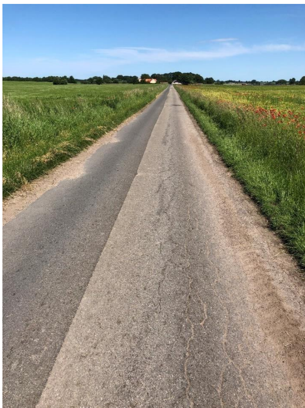
Fig. 7.3 (t.v.): Vådagervej før renoveringen. Gennemrevnet og krakeleret fra tunge landbrugs køretøjer.
