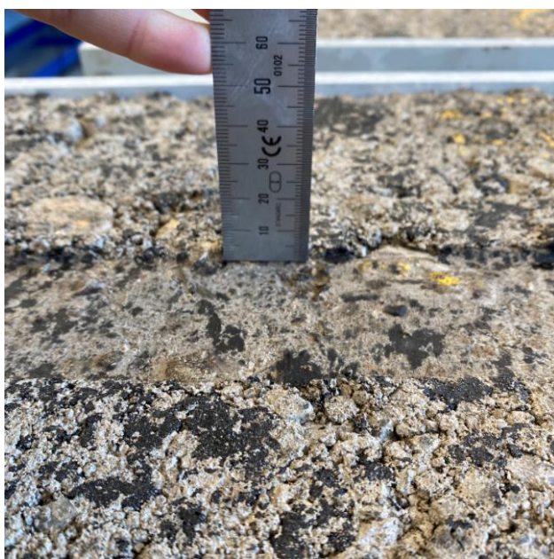
Fig. 6.7.2: Foto af BSM sporkøringspladens overflade efter afsluttet test. Trods den grove overflade ses blot 5 mm spordybde (her efterkontrolleret med målestok).
