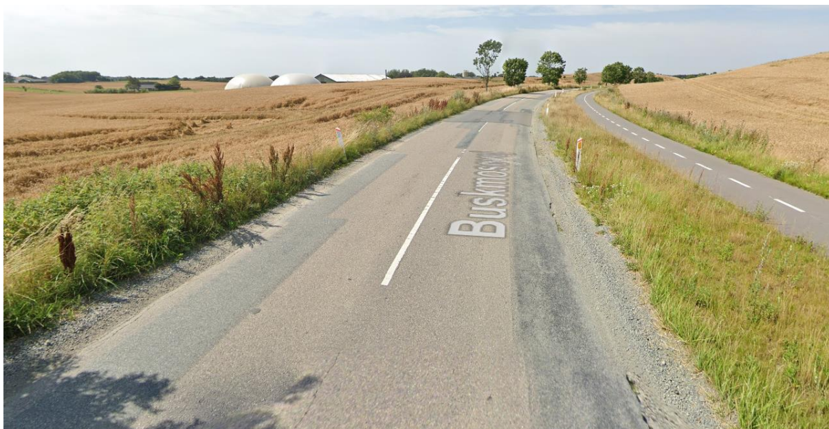
Fig. 2.4: Typisk billede af Buskmosevej før vejens istandsættelse (set mod vest). Kanterne knækker og krakelerer. Foruden næsten generelt udlagt OB i vejens ydersider ses også mange partielle OB-pletter/lapper, som vidner om omfattende krakeleringer og bæreevnemæssige udfordringer. (Kilde Google Maps, 2019)
