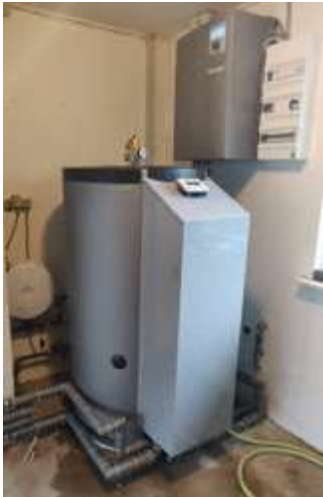
Figur 5. Installation med varmevekslermodul i den grå kasse øverst og varmelageret nederst.
