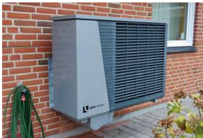
Figur 4. En Alpha-Innotec luft til vand monoblock-varmepumpe blev valgt som den teknisk bedste løsning. Kølemidlet er R290 (propan), som er tilgængeligt de fleste steder, og er mere miljøvenligt end HFC-kølemidler. Da installationen er udendørs, udgør kølemidlet ikke en brandfare for bygningen.
