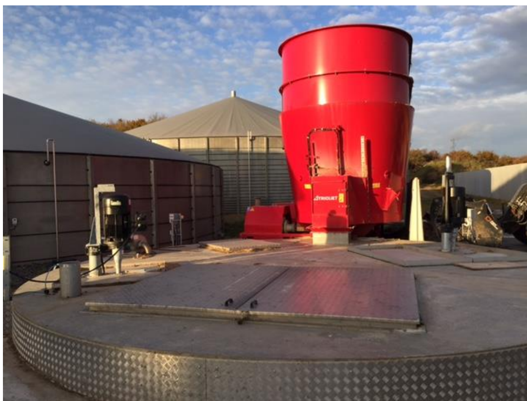
Figur 9. Standardsystem hos Lundsby Biogas, her hos Viftrup Biogas.
