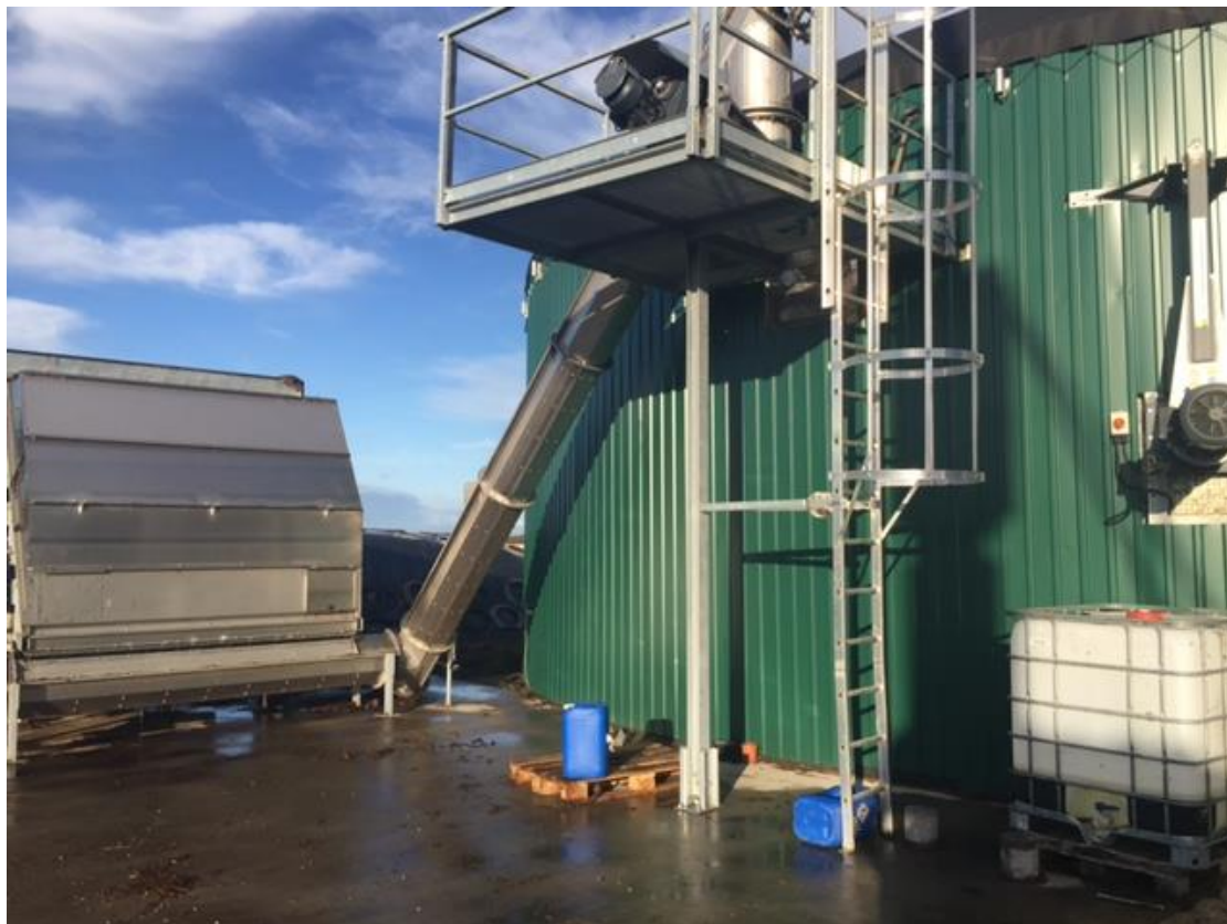
Figur 6. Snegle til løft og indføding, Kroghsminde Biogas
