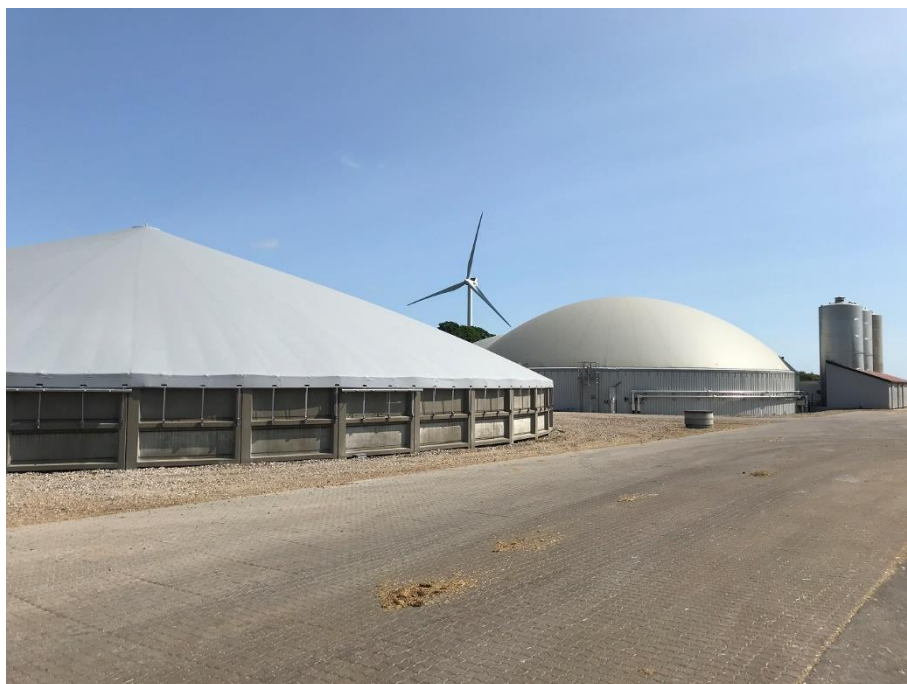
Ausumgaard Biogas. Forest en uopvarmet 'slavetank', der er forbundet til en opvarmet reaktortank i baggrunden. Desuden ses tanke til glycerin eller anden flydende biomasse.
