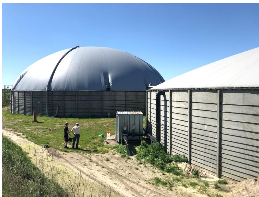
Biogasanlægget Vrejlev Bioenergi. Bagerst ses reaktoren og forrest ses efterlager 1.
