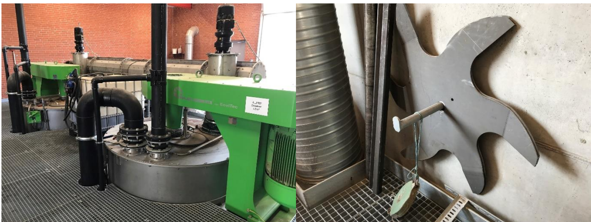
To Envitec-dissolvere à 4,5 m³ til opblanding af fast biomasse i gylle og recirkulat. Til højre ses nye stjerneknive, der sikrer omrøring og delvis neddeling i dissolverne.
