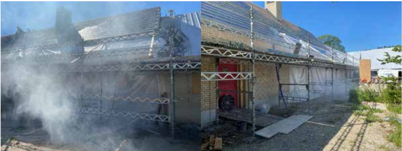
Figur 8.15 – Undersøgelse med røg, hvor der udvendigt er skabt et røgfylt kammer foran facaden, hvor røgen så trænger ind i bygningen.
