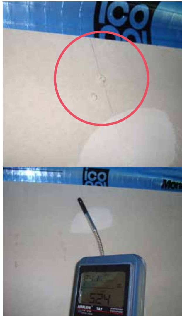
Figur 8.14 – Eksempel på en utæthed, hvor der måles 5,24 m/s, men det utætte område er et skruehul. Den luftmængde, der påvirker indeklimaet, er så lille, at det aldrig vil kunne påvirke indeklimaet.
