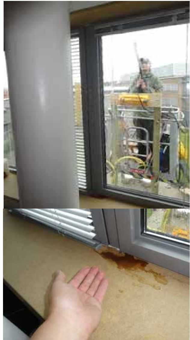
Figur 8.8 – Undersøgelse med vandpåvirkning af facaden til lokalisering af utætheder.
