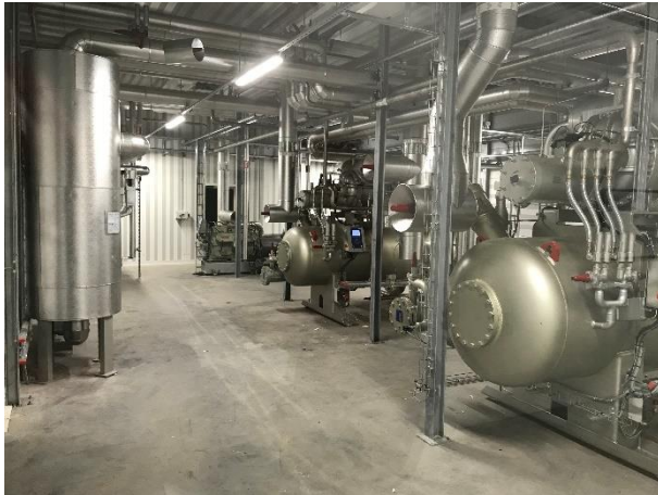
Figur 35: En del af elinstallationen (2020.11.26)
