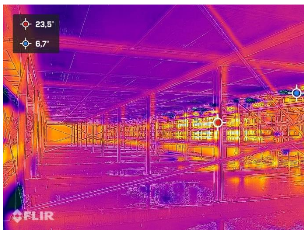
Figur 46: Termografisk billede af fordampers undersiden (2021.10.11)
