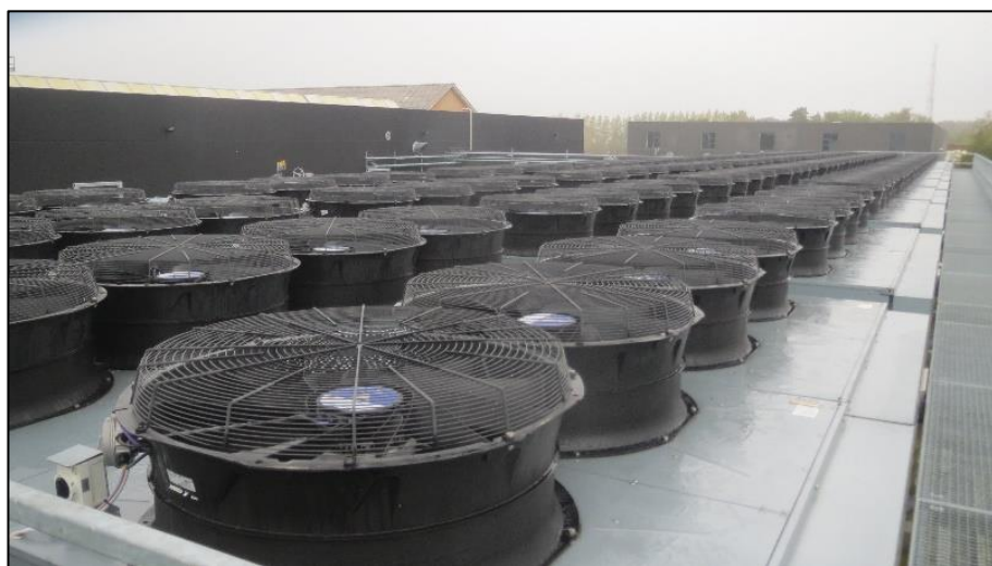
Figur 5: Et billede af fordamperne på anlægget ved Brædstrup Fjernvarme
