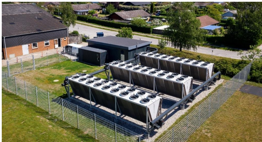
Foto: Slagslunde Fjernvarme, 1 MW varme , 2020
