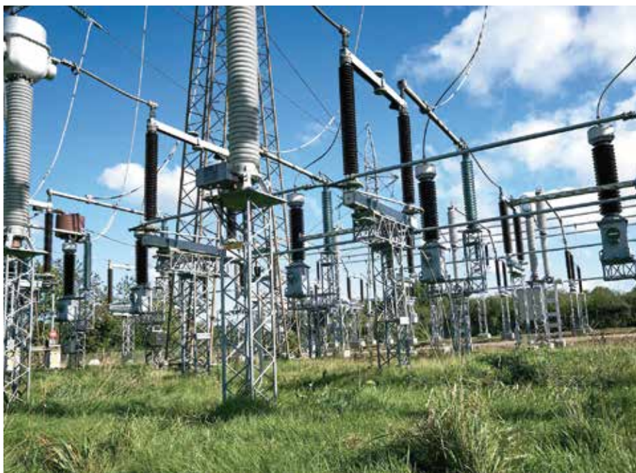
Foto 3. Ifølge Rambøll er det nødvendigt at forstærke og modernisere flere af de store transformerstationer, så de kan klare den forøgede fremtidige elbelastning.
