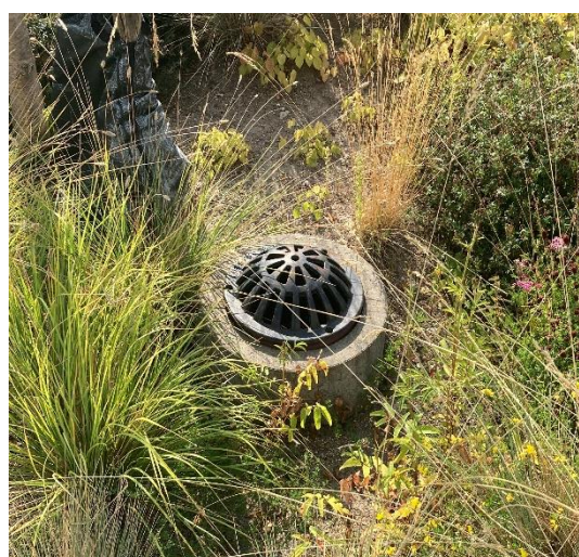
Figur 8: Hævet rist for overløb til faskine i regnbed. Foto: Teknologisk Institut.
