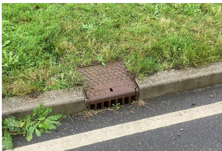
Figur 4: Rist i kantsten i toppen af vejstrækningen. Foto: Teknologisk Institut.
