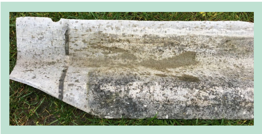
FIGUR 3. Tagplade fra nedrivning før afrensning.
