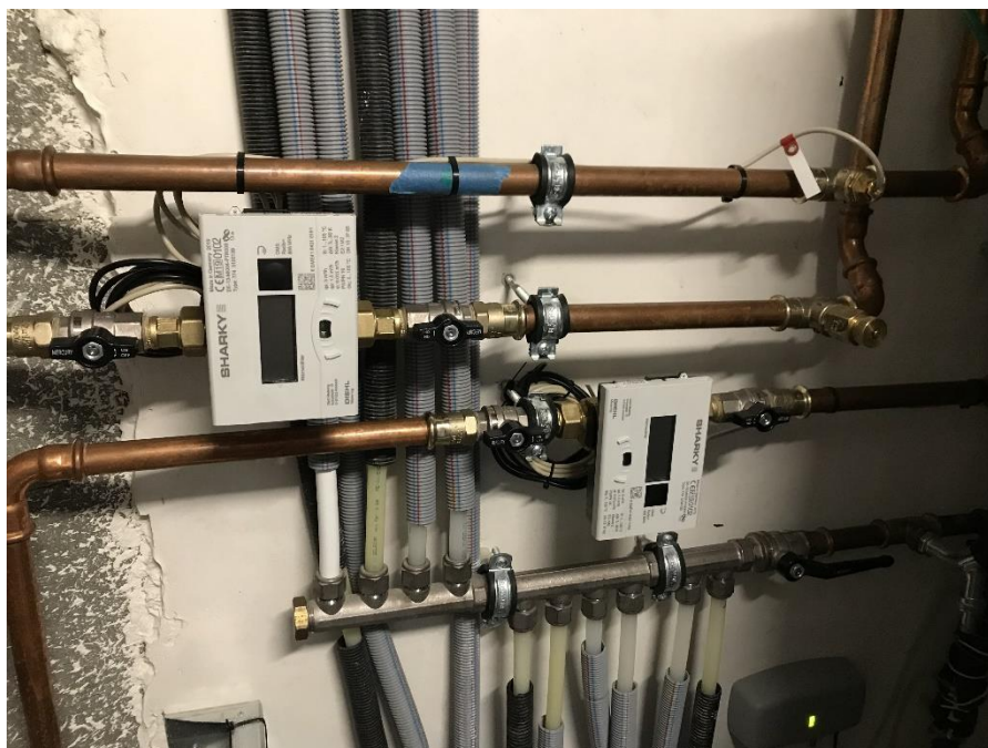
Figur 24 Sharky-varmemålere til rumvarme og varmt brugsvand.
