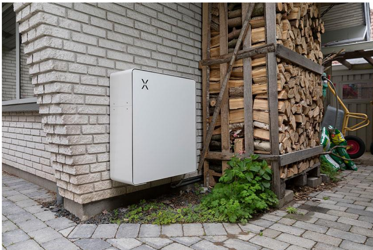
Figur 33 Udvendig montage af batteriet. Foto: Xolta.
