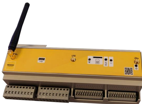
Figur 12 Gatewayen installeret i testhuset.
