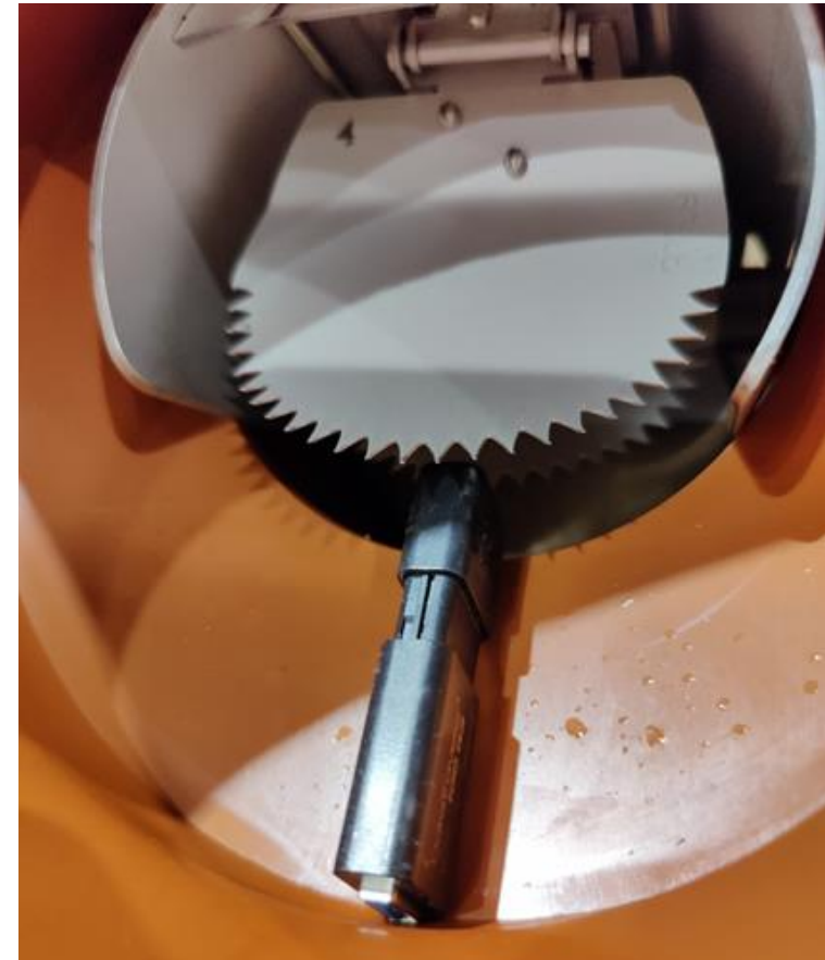
Rottespærre monteret i 160/110 reduktion
