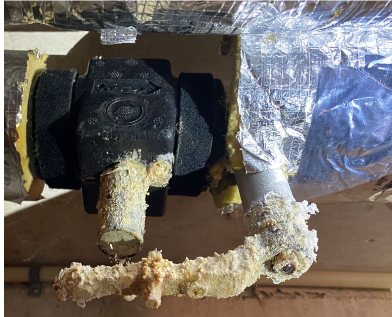
Indreguleringsventil på cirkulationsstreng defekt og utæt.
