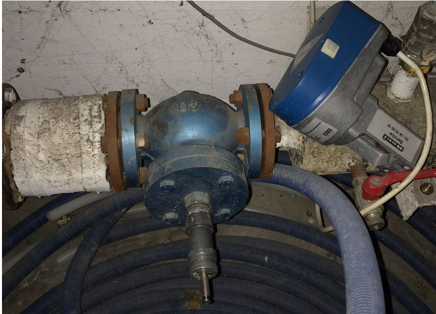
Motor pillet af motorventil.
