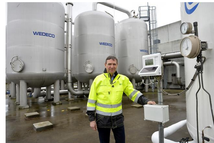
Kalundborg Forsyning, ozonanlæg
