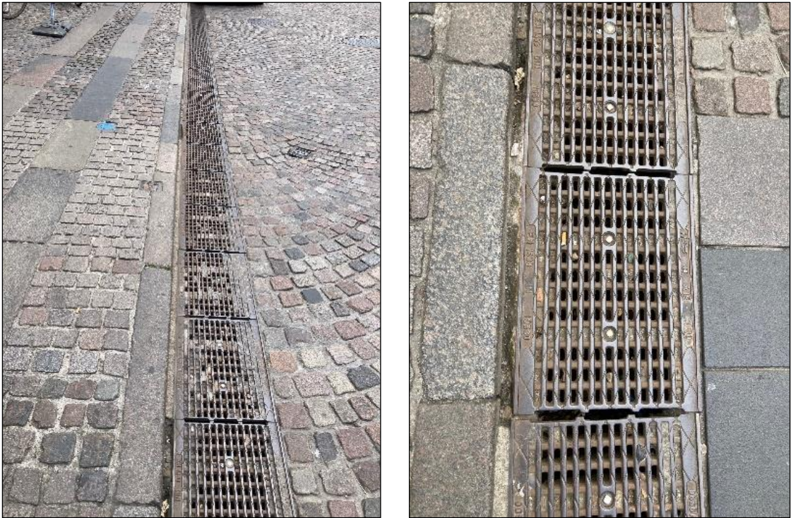
Figur 8.2. Riste over skybrudsrender skal fastgøres forsvarligt, så det sikres, at ristene ikke klapper.
