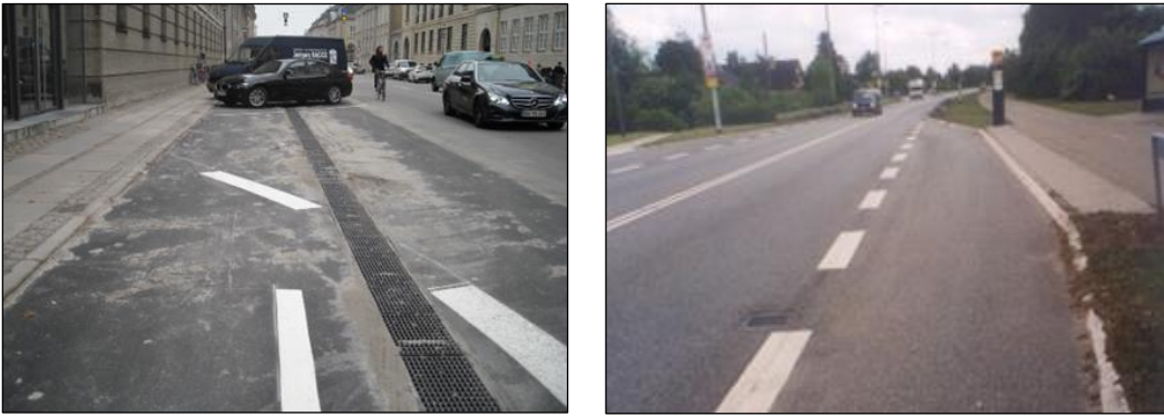
Figur 5.2. Figuren viser dels en rist placeret midt i et parkeringsareal, hvor der kan forekomme tung trafik, samt en rendestensrist, som fra starten nok er etableret i styrkeklasse 3, men etableringen af buslomme betyder en tungere trafikbelastning, og medfører, at den nu burde være klasse 4.
