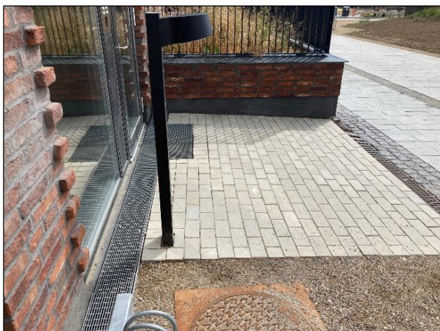
Figur 12.1. Indgangsparti med sokkelrende foran døren, stort fald på terræn væk fra bygning, og afløbsrende ved fortovet.
