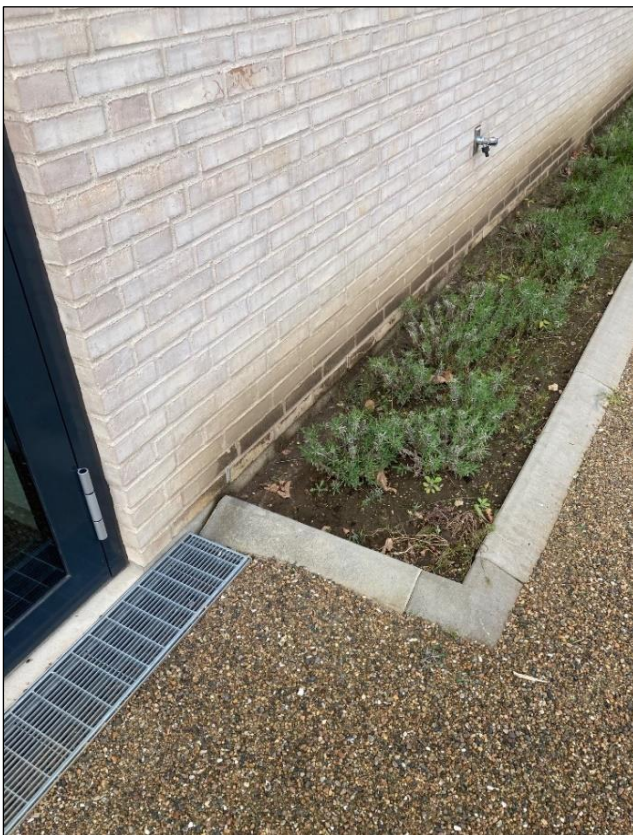
Figur 12.9. På nogle dele af facaden er der valgt en fri sokkelhøjde, dog kun på 8-10 cm. Der ses en tydelig påvirkning af facaden med fugt og misfarvning fra opsprøjt fra råjorden.
