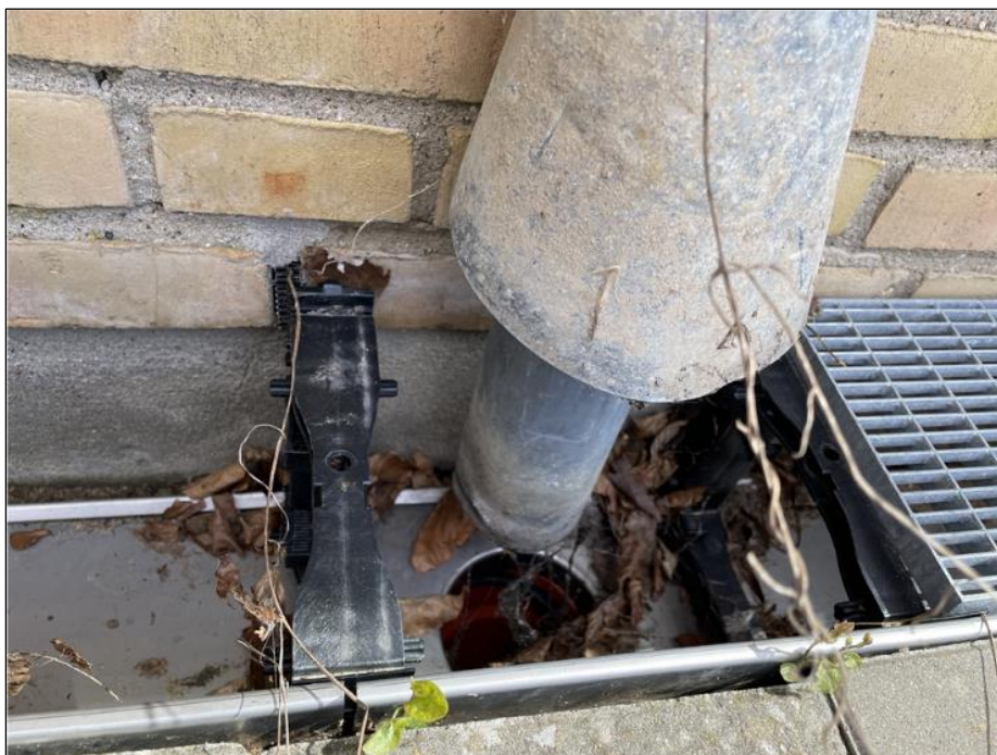
Figur 13.1. Tagnedløbet er ført ned i en sokkelrende med tæt bund, og slutter umiddelbart over afløbshullet. Regnvand fra tagnedløbet ledes ned i sokkelrenden, og løber over bagkanten ind mod soklen. Dette giver unødigt opfugtning af og lokalt vandtryk på soklen.
