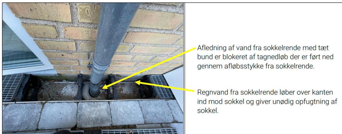
Figur 13.2. Tagnedløb, der er ført gennem sokkelrenden, men blokerer vandtransporten i renden, så soklen bliver opfugtet. Overløb mod soklen vil i opstuvningssituationer føre til periodisk vandtryk.
