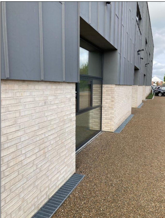
Figur 12.7. Ved de tilbagetrukne vinduespartier følger sokkelrenden ikke med.
