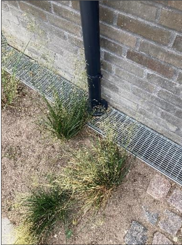
Figur 4.4. Tagnedløb skal føres gennem sokkelrenden i vandtætte gennemføringer og ledes til regnvandssystemet.
