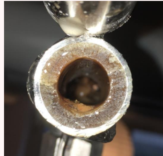
Billede af et overskåret varmtvandsrør. Dimensionen er 22 mm.
