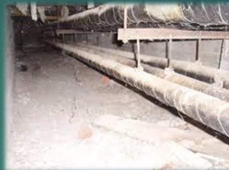
Koldtvandsrør påvirkes af varmtvandsrør
