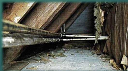
Uisolerede cirkulationsledninger i loftrum
