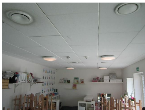
Figur 4.111 Nye belysningsarmaturer med dagslysstyring (lyset er dæmpet)
