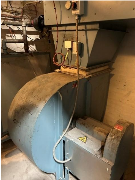
Figur 5.7. Indblæsningsventilator til sportshal
