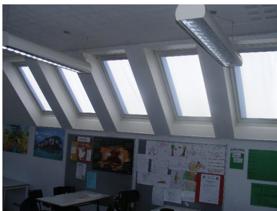
Figur 4.23. Belysningsarmaturer i klasselokale PIR-sensor placeret på væg
