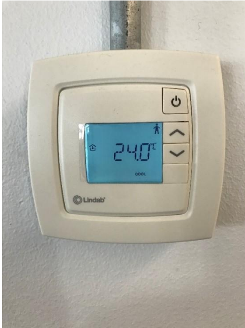
Figur 4.35. Temperatursensor placeret på væggen
