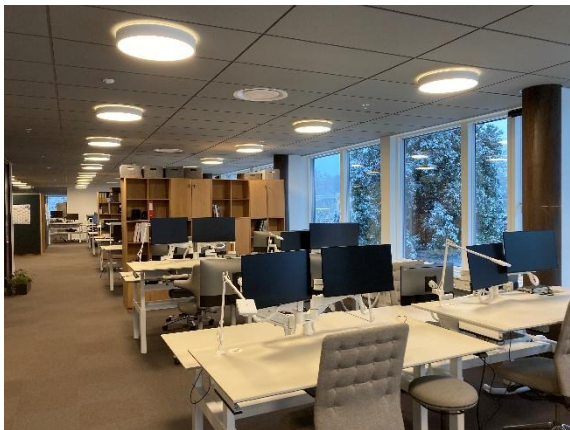
Figur 4.38. Belysningsarmaturer i kontorlokale med bevægelses- og dagslyssensorer
