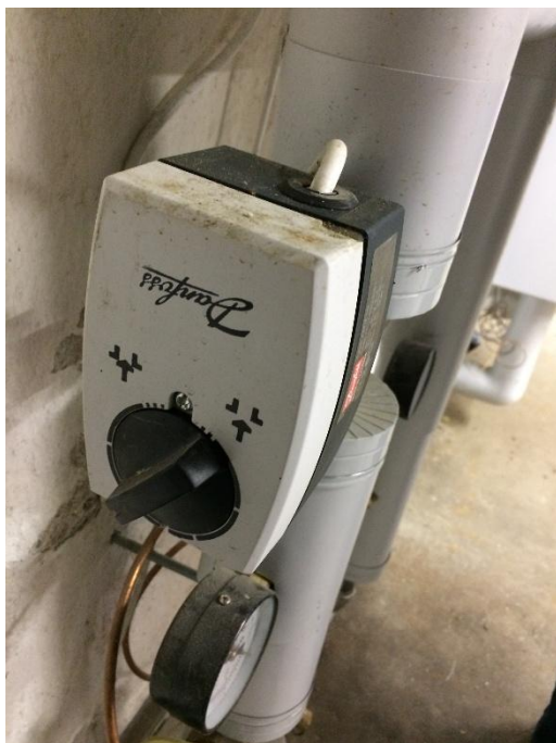
Figur 4.12. Reguleringsventil i blandekreds til radiatorsystem
