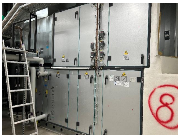
Figur 5.12. Ventilationsanlæg med indblæsning og udsugning samt varmegenvinding
