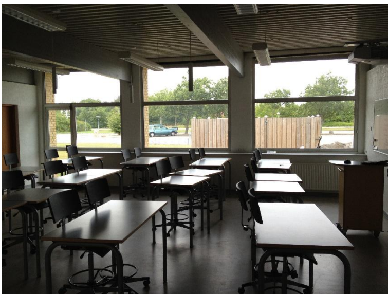
Figur 4.19. Belysningsarmaturer i klasselokale med manuel styring (kontakt på væg)
