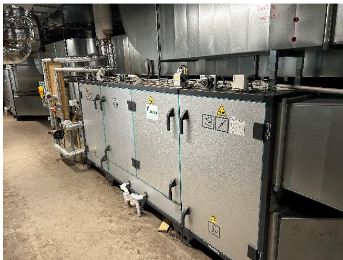
Figur 5.2. Ventilationsanlæg med indblæsning og udsugning samt varmegenvinding
