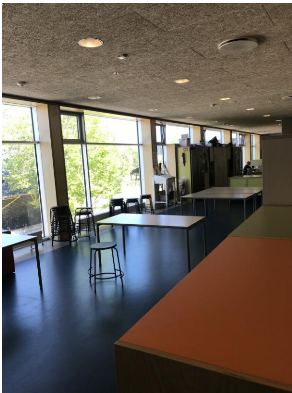
Figur 4.26. Belysningsarmaturer styret af PIR- og dagslyssensorer
