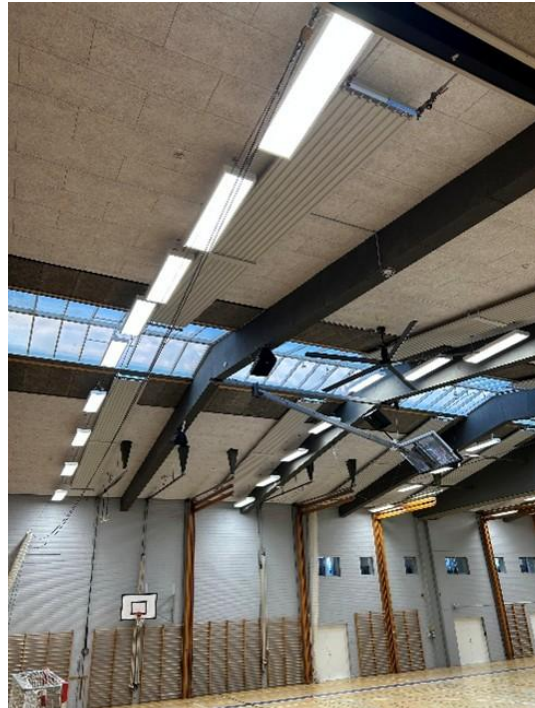
Figur 5.8. Belysningsanlæg i sportshal
