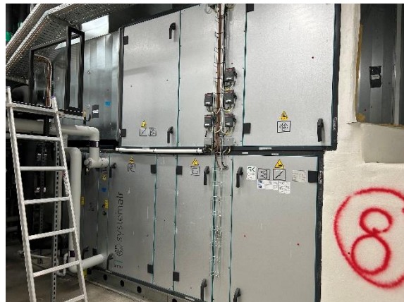
Figur 2. Ventilationsanlæg med indblæsning og udsugning samt varmegenvinding
