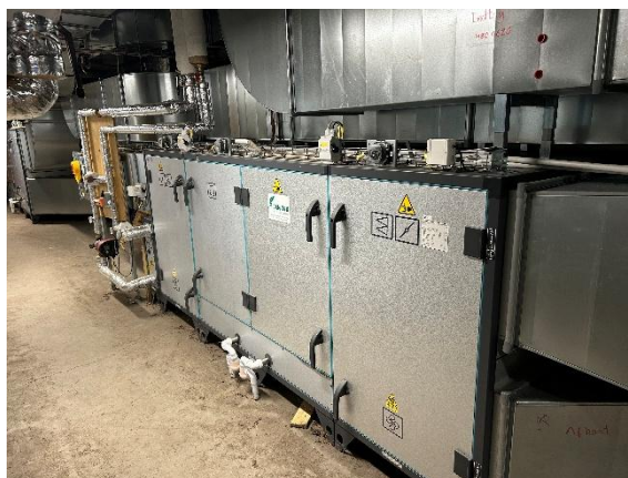
Figur 4. Ventilationsanlæg med indblæsning og udsugning samt varmegenvinding
