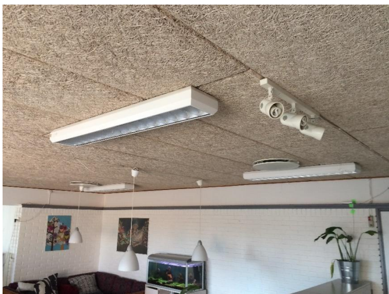
Figur 4.5. Belysningsarmaturer med manuel styring (kontakt på væg)
