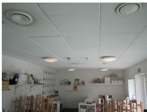
Figur 4.111 Nye belysningsarmaturer med dagslysstyring (lyset er dæmpet)
