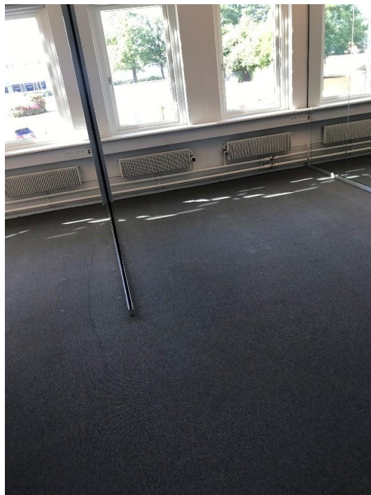
Figur 4.28. Radiatorer med manuelle termostatventiler
