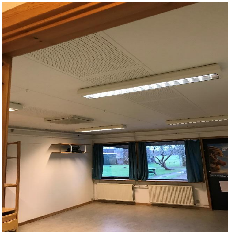
Figur 16. Belysningsarmaturer i lokale i daginstitution med manuel styring (kontakt på væg)
