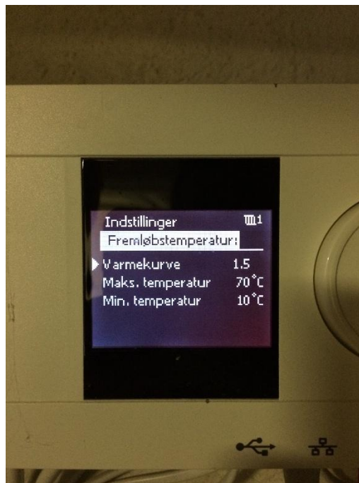
Figur 4.13. Udekompenseringsanlæg (indstilling af fremløbstemperatur)
