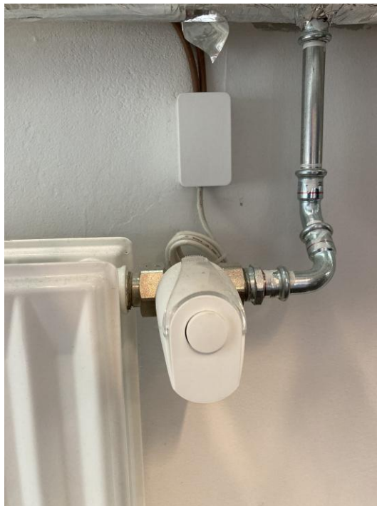
Figur 4.21. Motorventil på radiator
