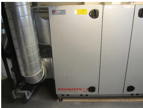
Figur 4.22. Ventilationsanlæg med indblæsning og udsugning samt varmegenvinding
