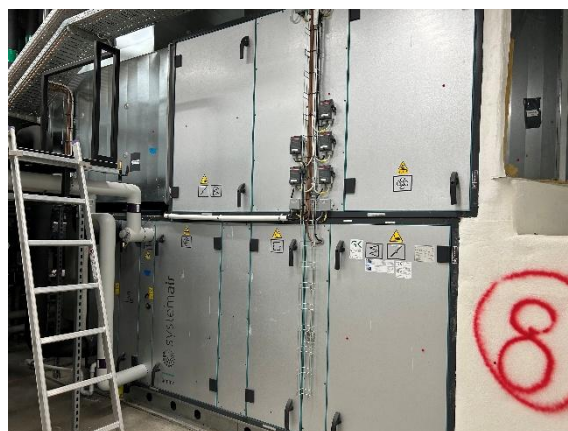
Figur 5.12. Ventilationsanlæg med indblæsning og udsugning samt varmegenvinding
