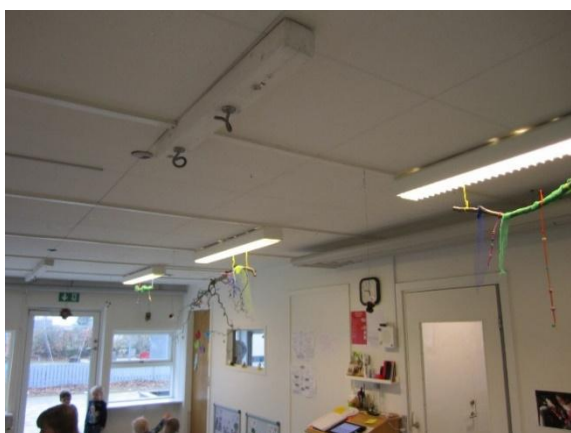
Figur 4.10 Ældre belysningsarmaturer med manuel styring (kontakt på væg)
