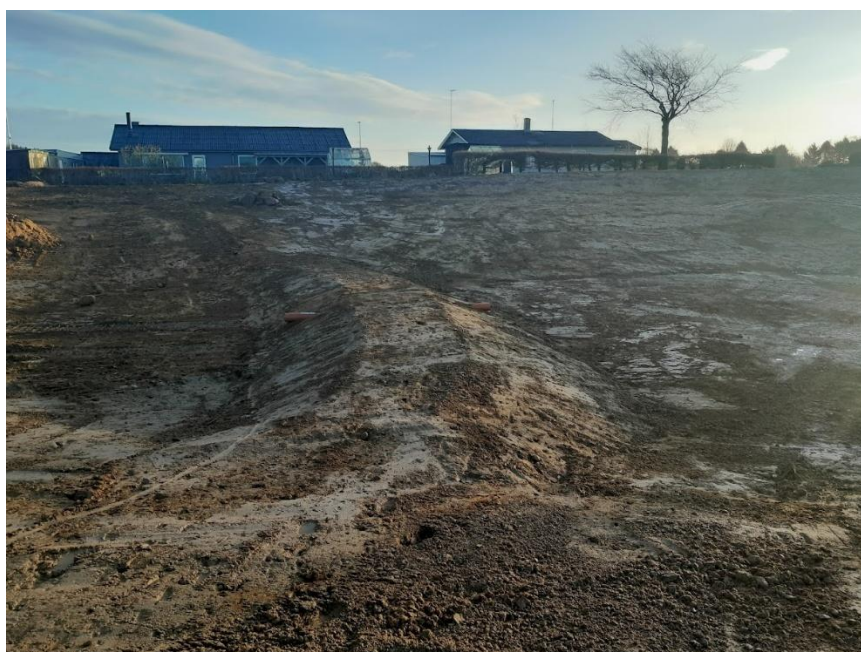
Figur 4.5: Foto fra etablering af vådt regnvandsbassin, med sektionsoptdeling i form af vold med lermembran. Permanent vandspejl er planlagt 20 cm over overkant af ler-vold (Foto: VAM A/S, 2023).
