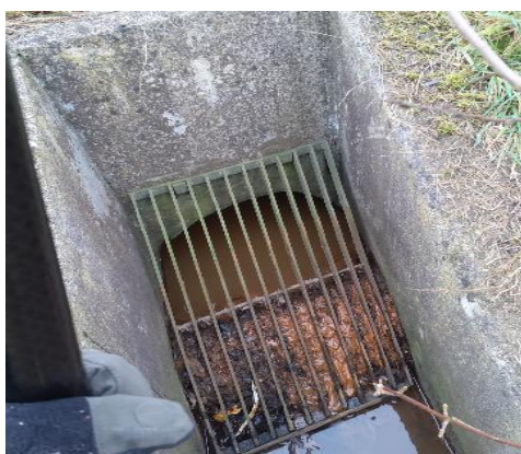
Figur 3.4: Tilløb med rist, hvor risten er stoppet til på bagsiden med blade m.m. (Foto: T. Aabling)
