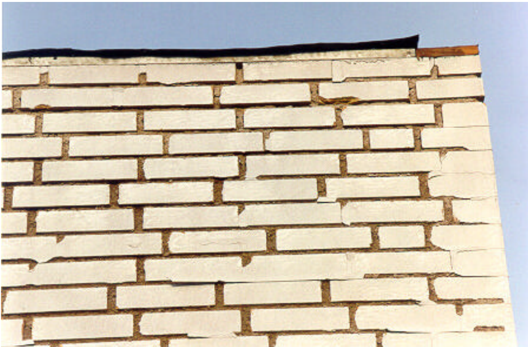
Figur 1. Frostska­det murværk. Frostska­det pga. mangelfuld afdækning og for tidlig overfladebehandling.
